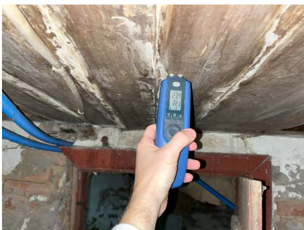
Skimmelbegroninger på loft/gulvbrædder og fugtmåling i kælder
