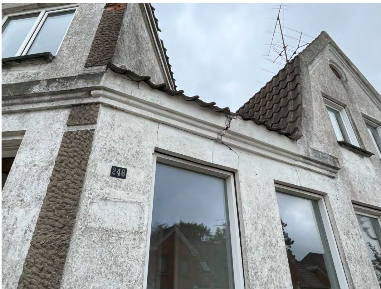
Forskydningsrevne i facade
