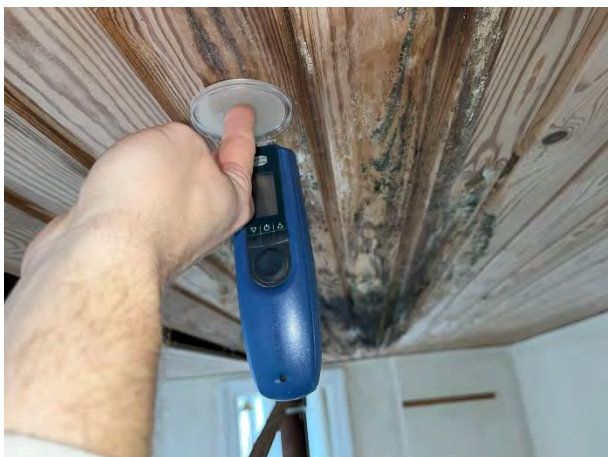
Skimmelprøve nr. 1, på loft i den sydlige stue
