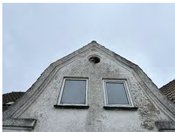
Glas i kvistvindue ikke intakt
