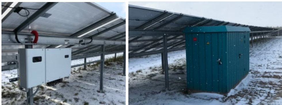
Figur 1-5 Invertere placeres under solpanelerne. Transformere placeres spredt i området og skjules under solcellepanelerne.
