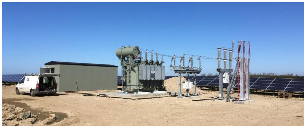
Figur 1-6 Eksempel på stepup-transformer og teknikbygning.
