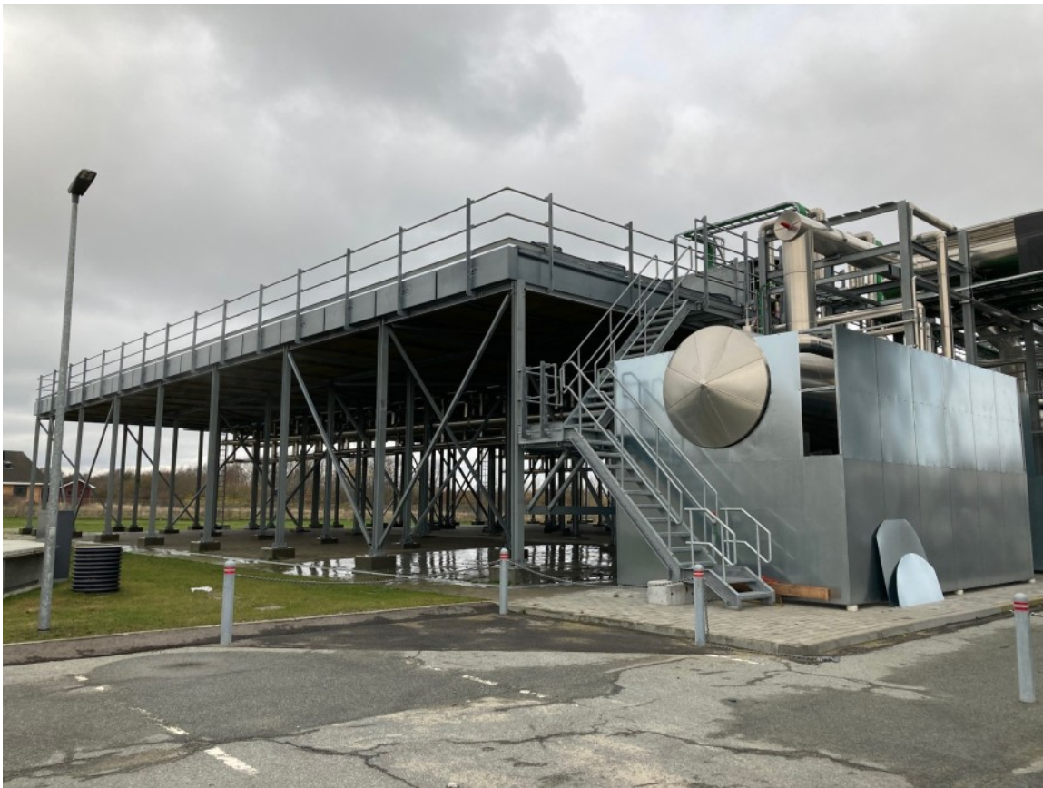
Figur 2: Energioptageren, der er placeret vest for selve varmecentralen (COWI A/S).
