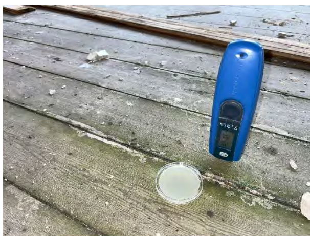
Skimmelprøve nr. 4, på gulv i den sydlige stue
