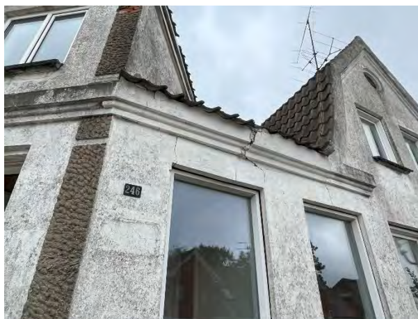
Stor forskydningsrevne i facade
