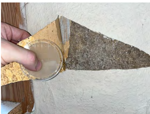
Skimmelprøve nr. 2, bagside af tapet i den sydlige stue
