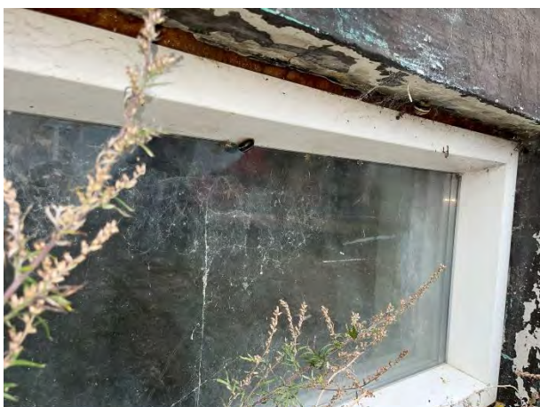
Manglende fuger ved kælder vindue
