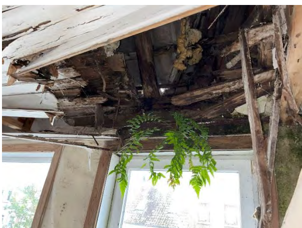
Hul/sammenstyrtning i taget i køkken
