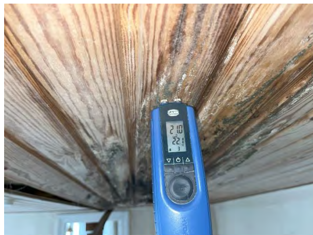
Fugtmåling af loft ved prøvested nr. 1
