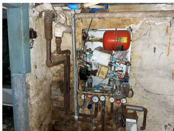
Varmeanlæg i kælder
