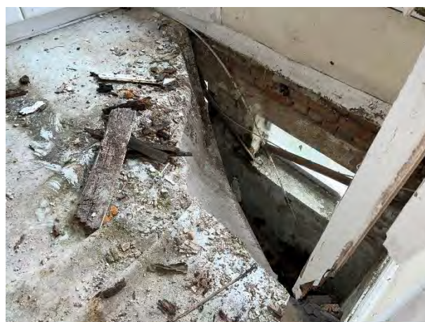
Sammenstyrtning af etageadskille i køkken
