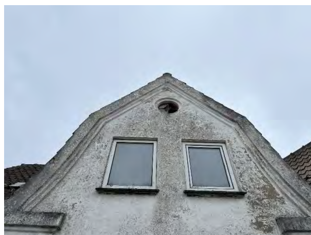
Glas i kvistvindue ikke intakt
