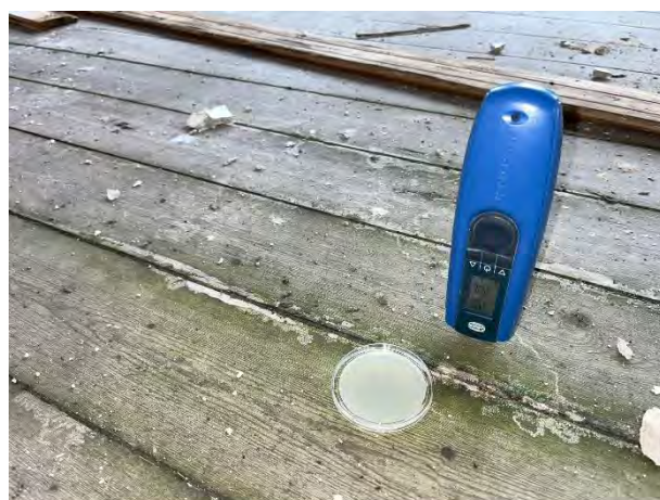
Skimmelprøve nr. 4, på gulv i den sydlige stue
