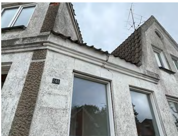
Stor forskydningsrevne i facade
